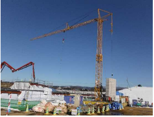
写真-2 定置式水平ジブクレーン
