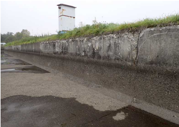
写真-4 凍害劣化と摩耗劣化の状況
