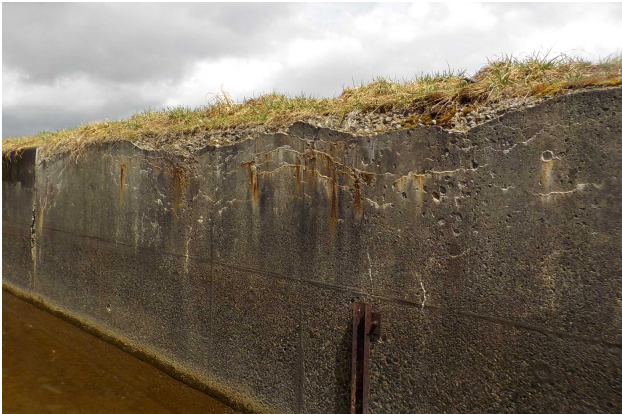
写真-1 凍害劣化状況
