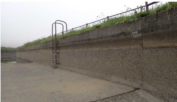
写真-2 摩耗劣化状況
