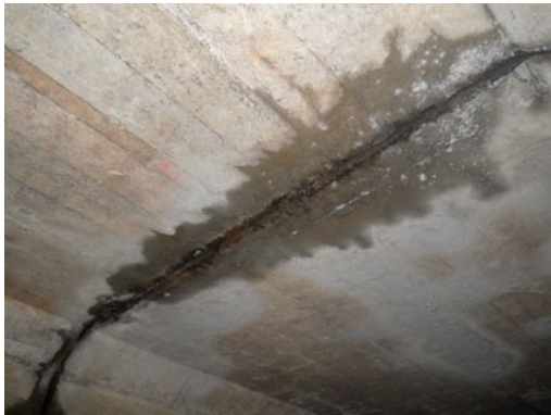
図-6 目地の脱落、湧水
