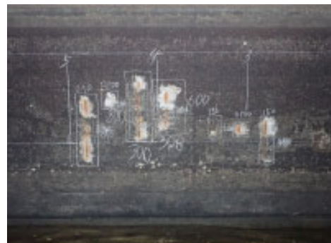
図-5 鉄筋腐食に伴うコンクリート剥落
