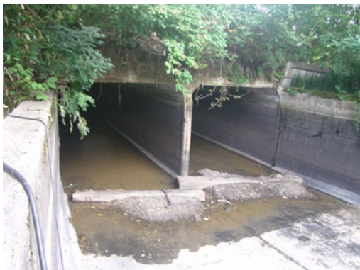
図-8 呑吐口部の崩落(背面土の凍上圧による崩壊)
