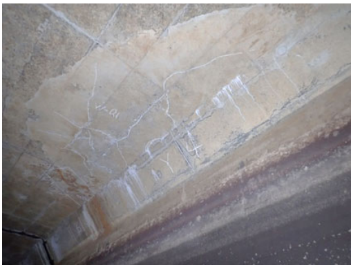
図-7 乾燥収縮ひび割れ(頂版)
