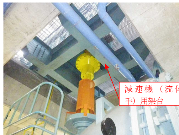
写真-10 減速機 (流体継手) 用架台
