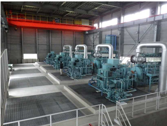
写真-1 お茶の水排水機場内観
