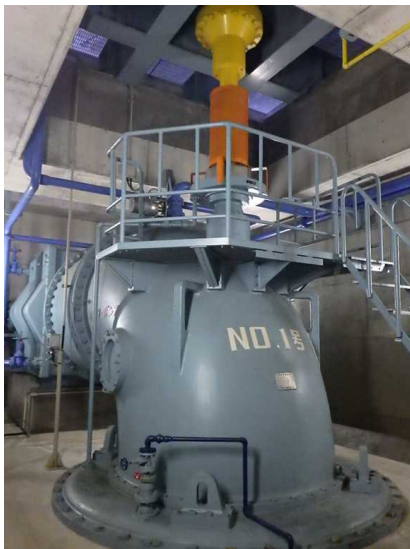
写真-2 お茶の水排水機場主ポンプ外観
