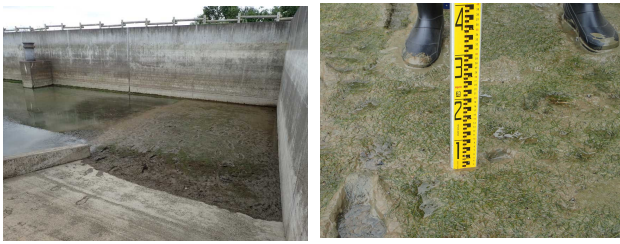
写真3 追分ファームポンド及び施設内の堆砂状況
