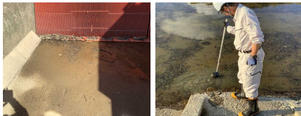
写真5 道央注水工施設内、馬追調整池の堆砂状況
