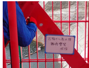
写真-13 塗膜補修前
