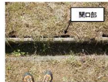
写真-2 約2週間後(9月18日)に確認した変状
