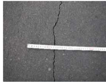
写真-1 地震直後(9月6日)に確認した変状
