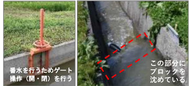
写真-1 ほ場への分水状況
