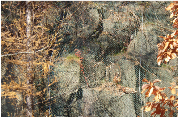
写真-1 岩塊の露出 (大平22工区付近)
