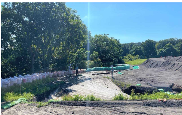
写真-12 8月の大雨時に土砂溜が満杯となり大型土のうで土砂流出を防止している状況(大平22工区)
