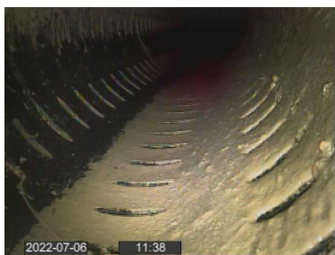
写真-7 暗渠管内の土砂堆積 (B圃場、2022年7月6日撮影)
