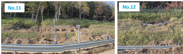
写真-8 被災状況写真（平成28年9月20日撮影）
