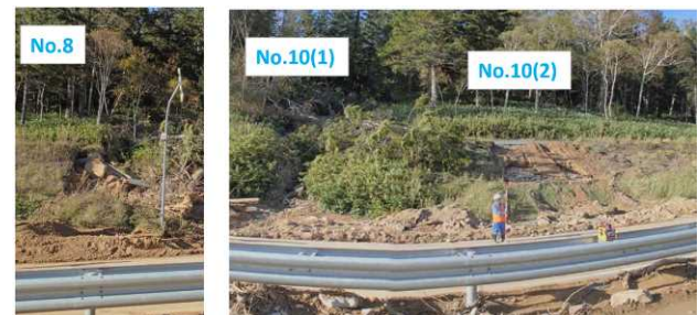
写真-7 被災状況写真（平成28年9月29日撮影）
