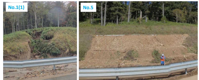
写真-1 侵食(左)、表層崩壊(右) (平成28年9月29日撮影)
