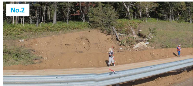
写真-6 No. 2表層崩壊写真（平成28年9月29日撮影）
