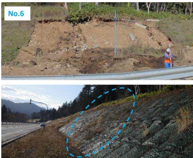
写真-3 No. 6被災状況写真（平成28年9月29日撮影・上段） 特殊布団かご設置状況（令和4年10月31日撮影・下段）
