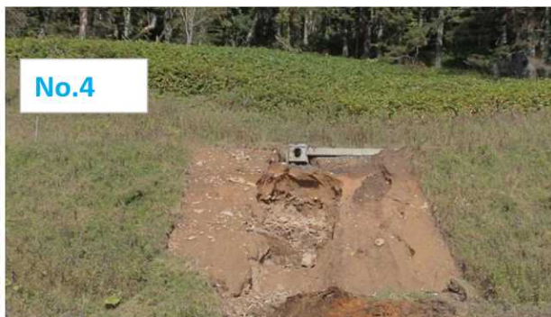
写真-4 No. 4排水柵被災状況（平成28年9月29日撮影）
