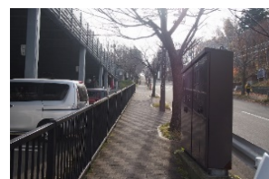
写真-16 地上機器と立体駐車場
