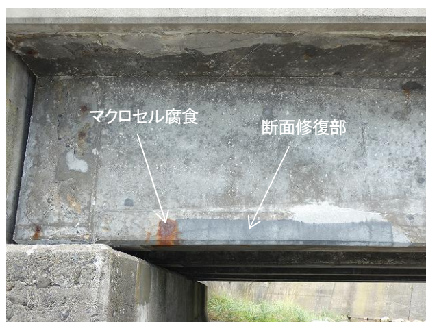
写真-1 マクロセル腐食が発生した道路橋主桁
