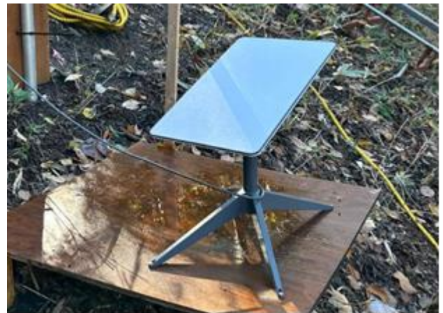
図-5 設置した衛星インターネットコンステレーション
