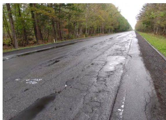
写真-3 苫小牧市丸山の舗装劣化状況(2023.5撮影)
