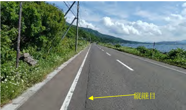
写真-2 縦継目（一般国道229号寿都町種前）
