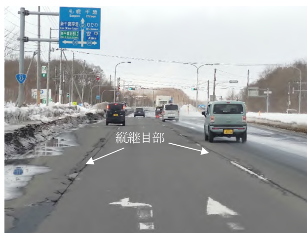
写真-1 縦継目部からの浸水に起因するポットホール
