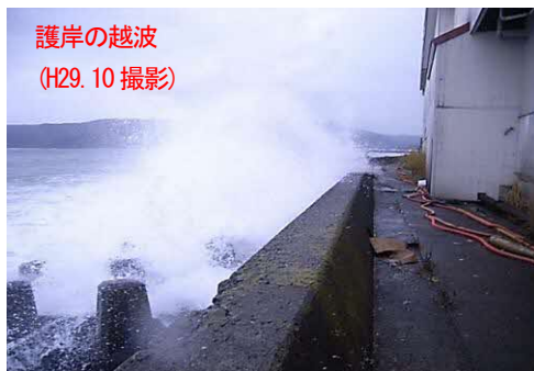
写真-1 護岸の越波
