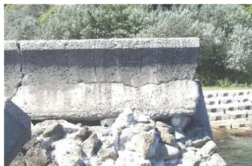
写真-2 護岸の老朽化
