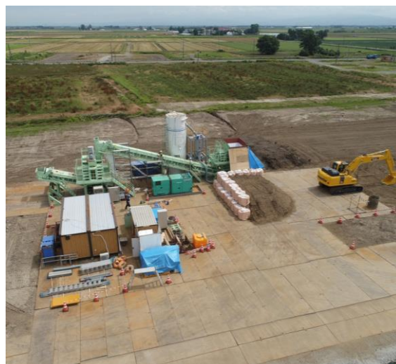
図-2 固化破碎土製造プラント
