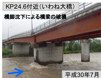
図-3 平成30年いわね大橋の橋脚破損
