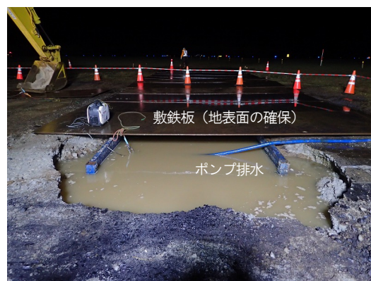
図-14 掘削箇所の冠水状況
