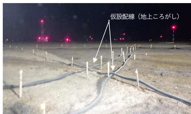
図-19 複雑な地上ころがし配管
