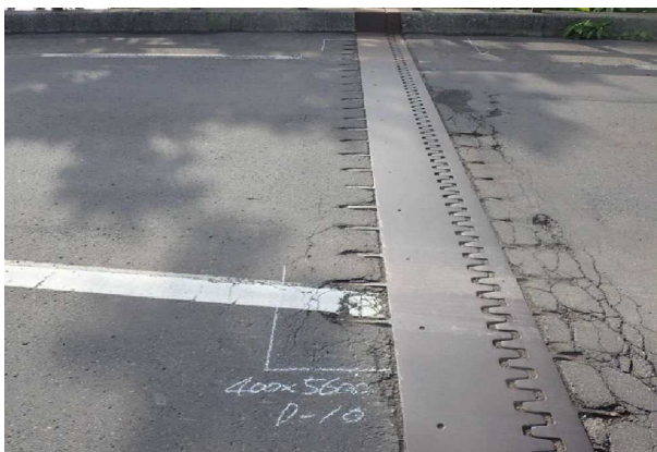
写真-3 As舗装接続の舗装損傷状況
