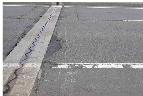
写真-6 後打Co立上境界部舗装損傷
