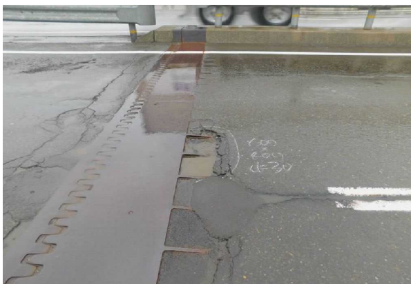
写真-5 スノープラウ誘導板部分の滞水状況
