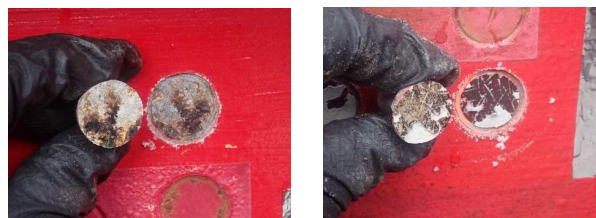
写真-3 引張付着試験 剥離箇所状況写真(No.3 ゲート表面)
