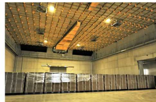
写真10 冷蔵貯蔵施設内部
