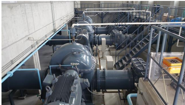
写真-1 北生振揚水機
