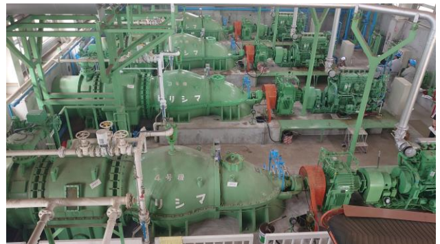
写真-4 金子排水機場
