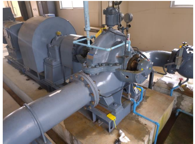
写真-2 シップ揚水機場
