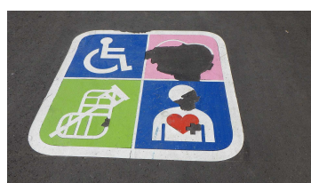
写真-7 路面標示シートの剥がれ(浜頓別)
