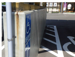
写真-12 樋接合部からの錆汁
