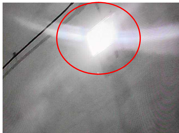
写真-8 一般国道229号西河トンネルL側No.10 LED
