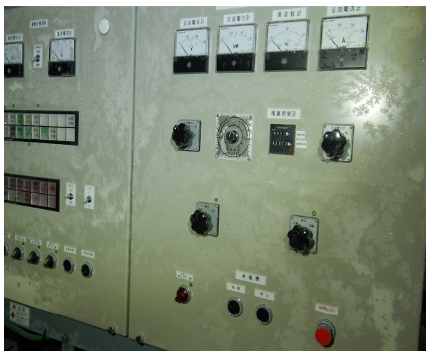
写真-6 非常用発電機盤への着霜
