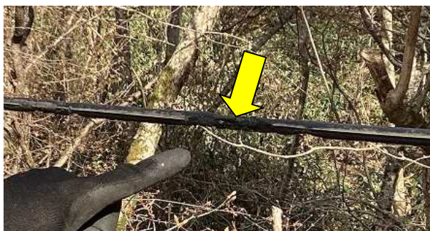
写真-7 架空高压電線の外傷
