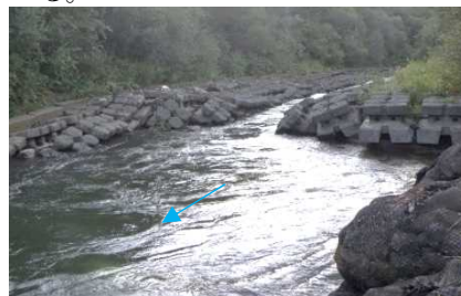
写真-1 根固ブロックの露出、沈下・浮き上がり(A地点)
