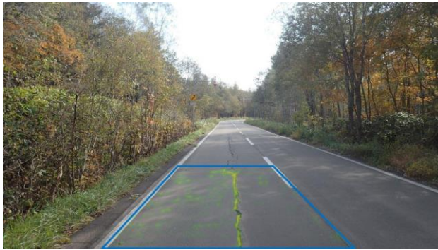
図-4 深層学習を用いた画像解析結果の例 (検出結果の一例：凍上ひび割れの例)
