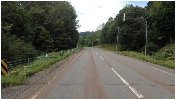
写真-2 低温ひび割れ画像の例
