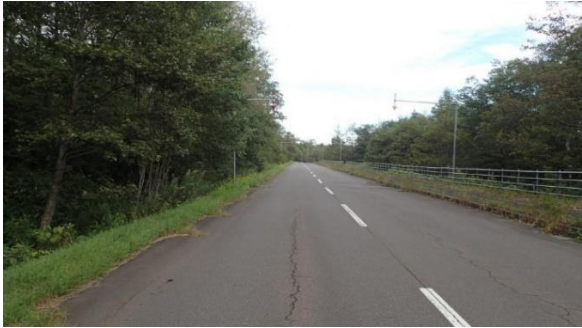
写真-3 凍上ひび割れ画像の例
