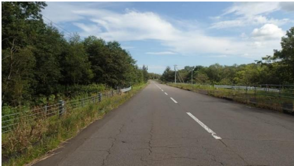
写真-4 亀甲状ひび割れ画像の例
