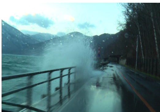
写真-6 KP43.7 付近 岸壁に打ち付ける波が強く越波を確認できる。
