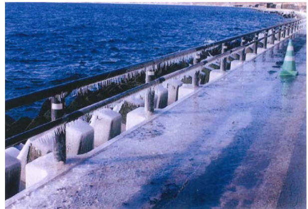
写真-3 越波による影響（路面の凍結）
