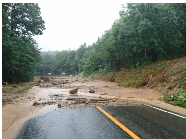
図-7 国道39号石北峠(KP=100.2)の土砂流出状況
