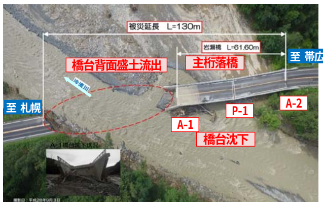
写真-8 岩瀬橋 被災状況
