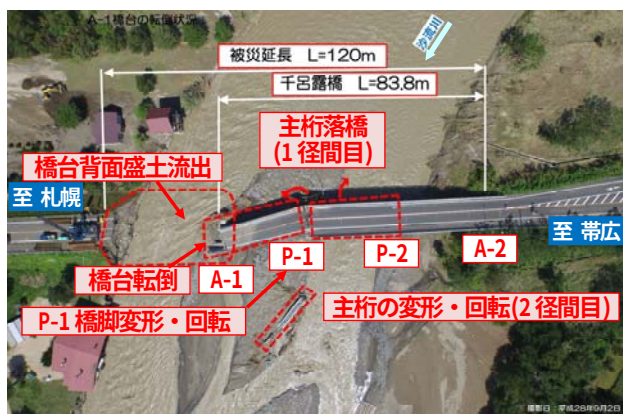
写真-4 千呂露橋 被災状況
