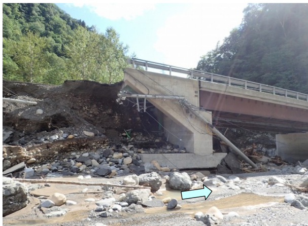
写真-12 ニセクシュマナイ橋 被災状況
