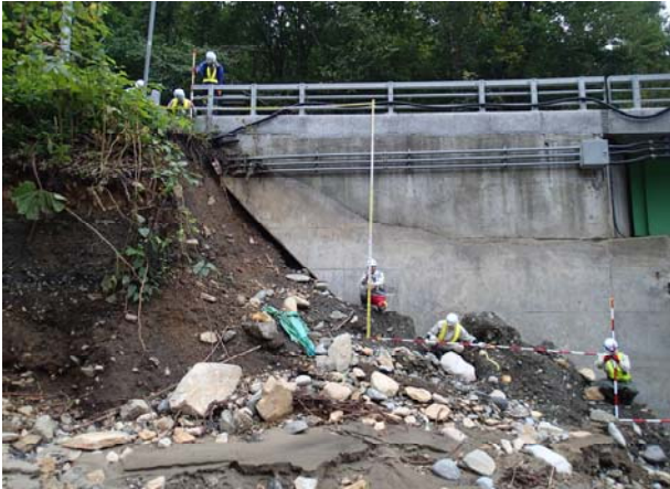
写真-11 清瀬橋 被災状況
