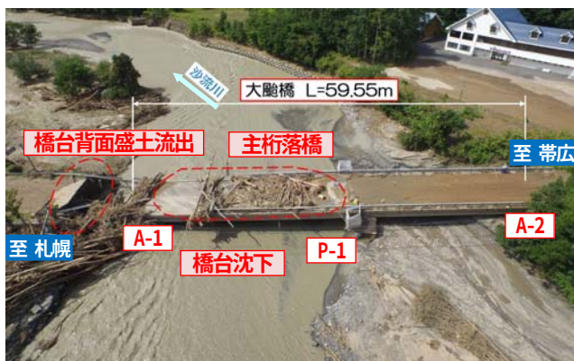
写真-6 大鷲橋 被災状況
