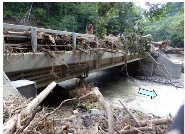
写真-14 鹿鳴橋 被災状況
