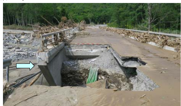
写真-10 日栄橋 被災状況
