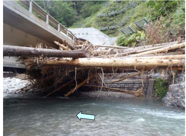
写真-13 新岩魚橋 被災状況
