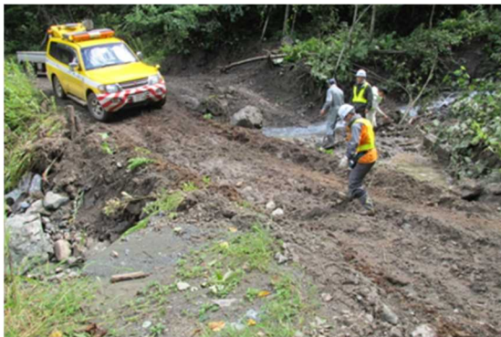
写真-5 青林道の状況
