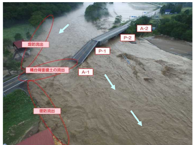
写真-4 千呂露橋損傷状況
