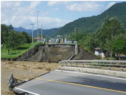
写真-1 千呂露橋の被災状況 (A1側より)
