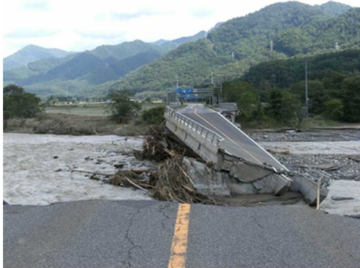
写真-2 千呂露橋の被災状況 (P1側より)
