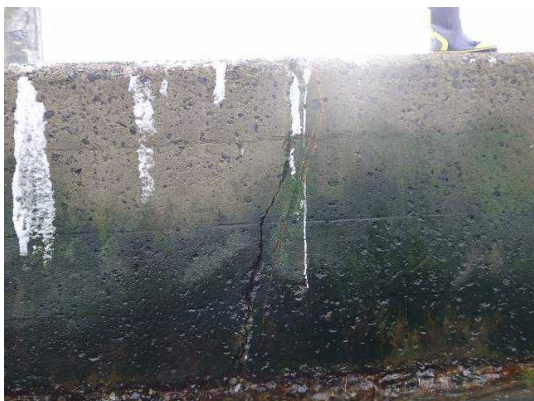
写真-2 上部工劣化状況
