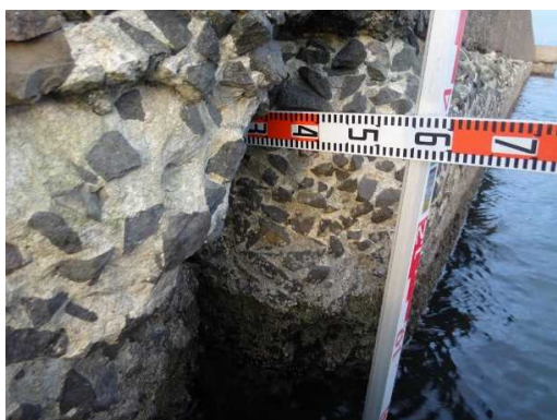
写真-3 本体工劣化状況（水上）
