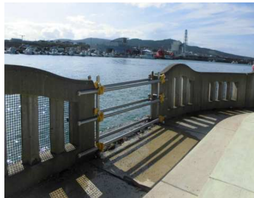
図-2 第3防波堤高欄劣化状況(応急対応中)
