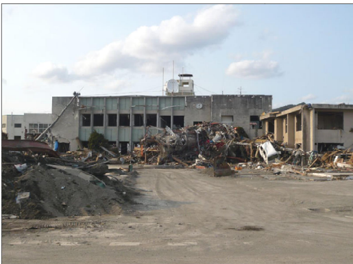
写真-1 津波災害を受けた庁舎（出典：岩手県大槌町）
