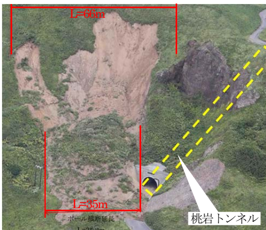
図-6 平成 26年 8月 24日災害全景（元地側）
