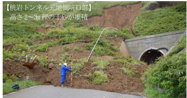
図-7 平成 26年 8月 24日災害状況 1
