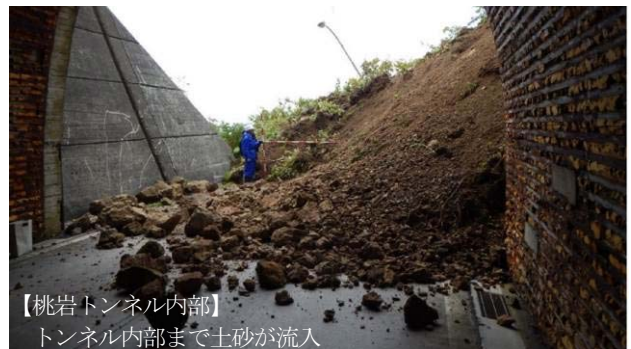
図-8 平成 26年 8月 24日災害状況 2
