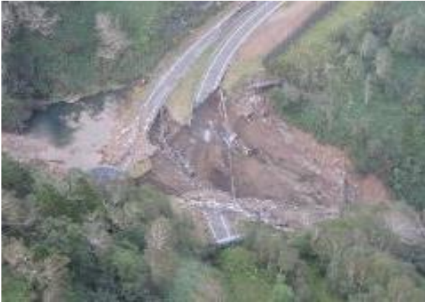
写真-2 清水町側大規模盛土崩壊
