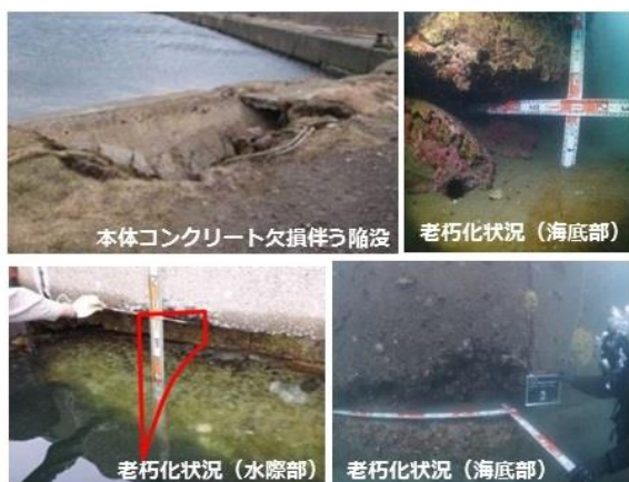
写真-3 国有港湾施設のコンクリート構造物 （プレパックドコンクリート）の老朽化状況
