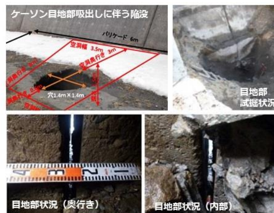
写真-2 国有港湾施設のコンクリート構造物（ケーソン式）の老朽化状況
