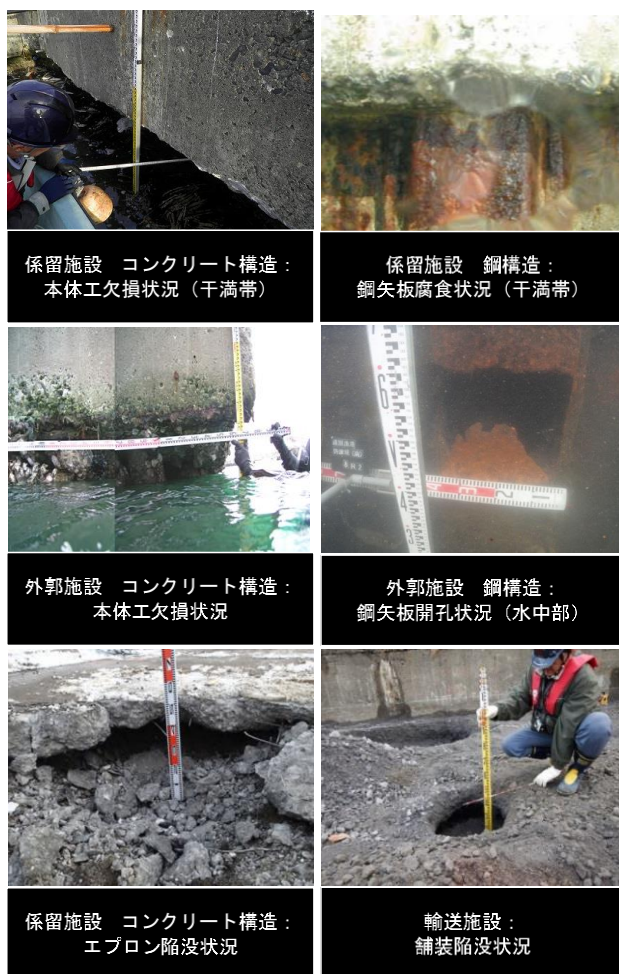
写真-4 漁港施設の老朽化状況
