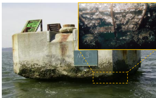
写真-8 コンクリート構造物劣化事例
