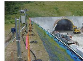
トンネル坑口モバイルルーター設置 (トンネル・4.9GHz)
