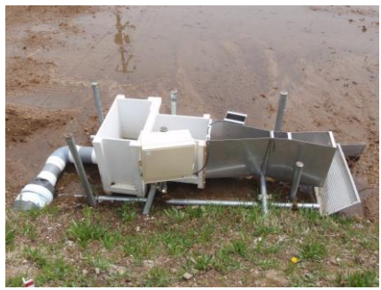
写真-1 パーシャルフリューム
