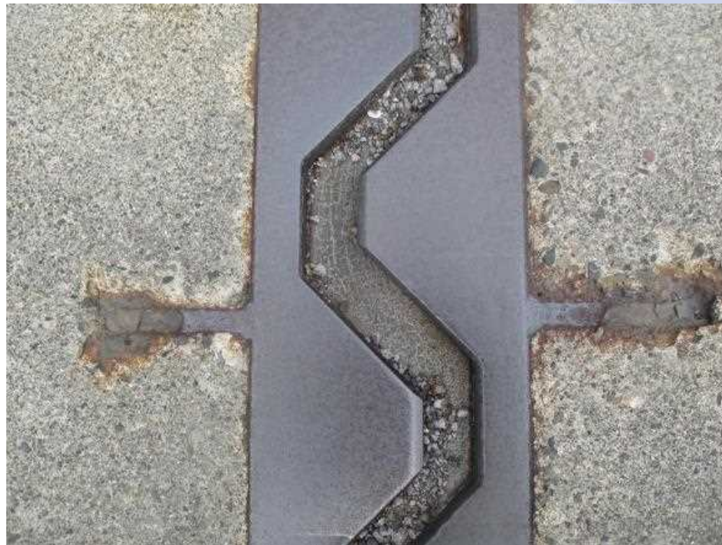
既存止水ゴムの劣化（紫外線）
