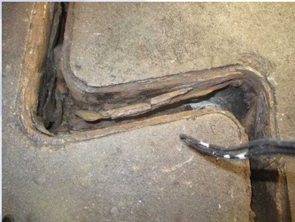
鋼材部の劣化
