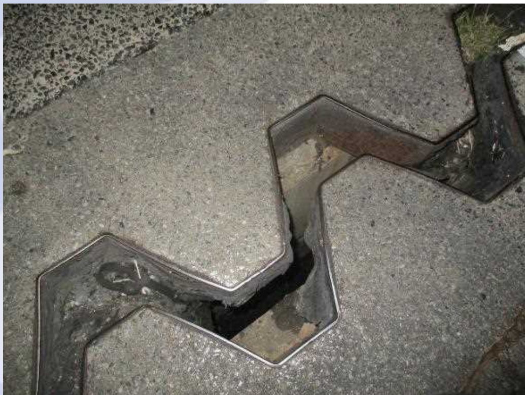
既存止水ゴムの劣化（外力）
