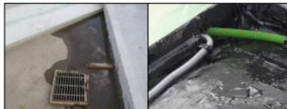
雨水が滞留している例
