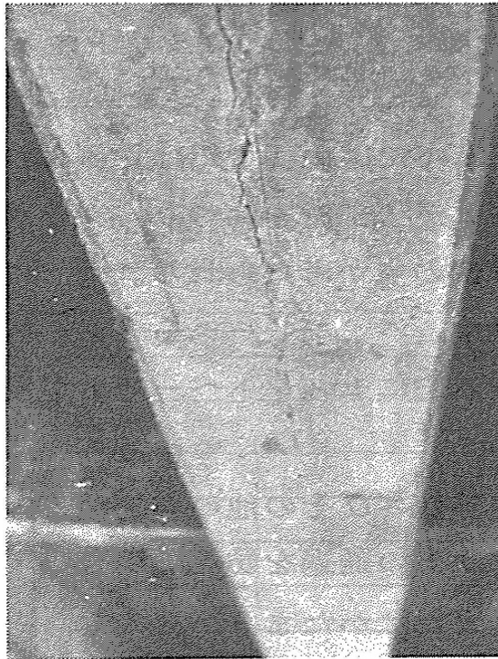
写真-9.4 グラウトの凍結による ひび割れ PCケーブルに沿って 発生したひび割れ
