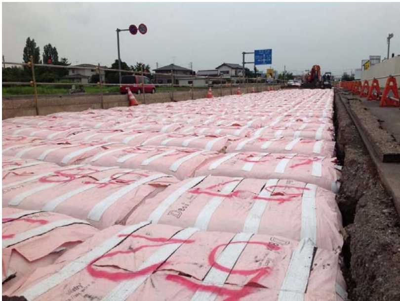
写真-3: S県内国道バイパスの軟弱地盤の路床に使用した例（2012年）
