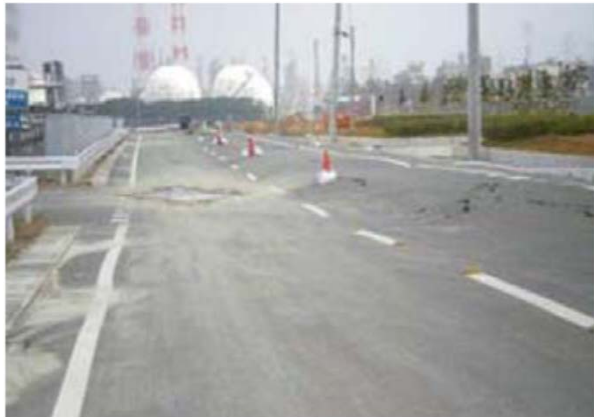
震災時の液状化状況-1
