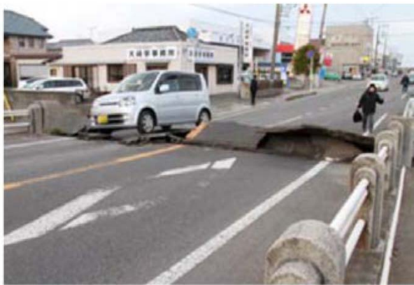
震災時の液状化状況-2
