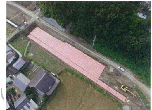
写真2 ■ 上の写真はD・BOXの設置作業の様子。下は設置済みの箇所を上から見たところ
