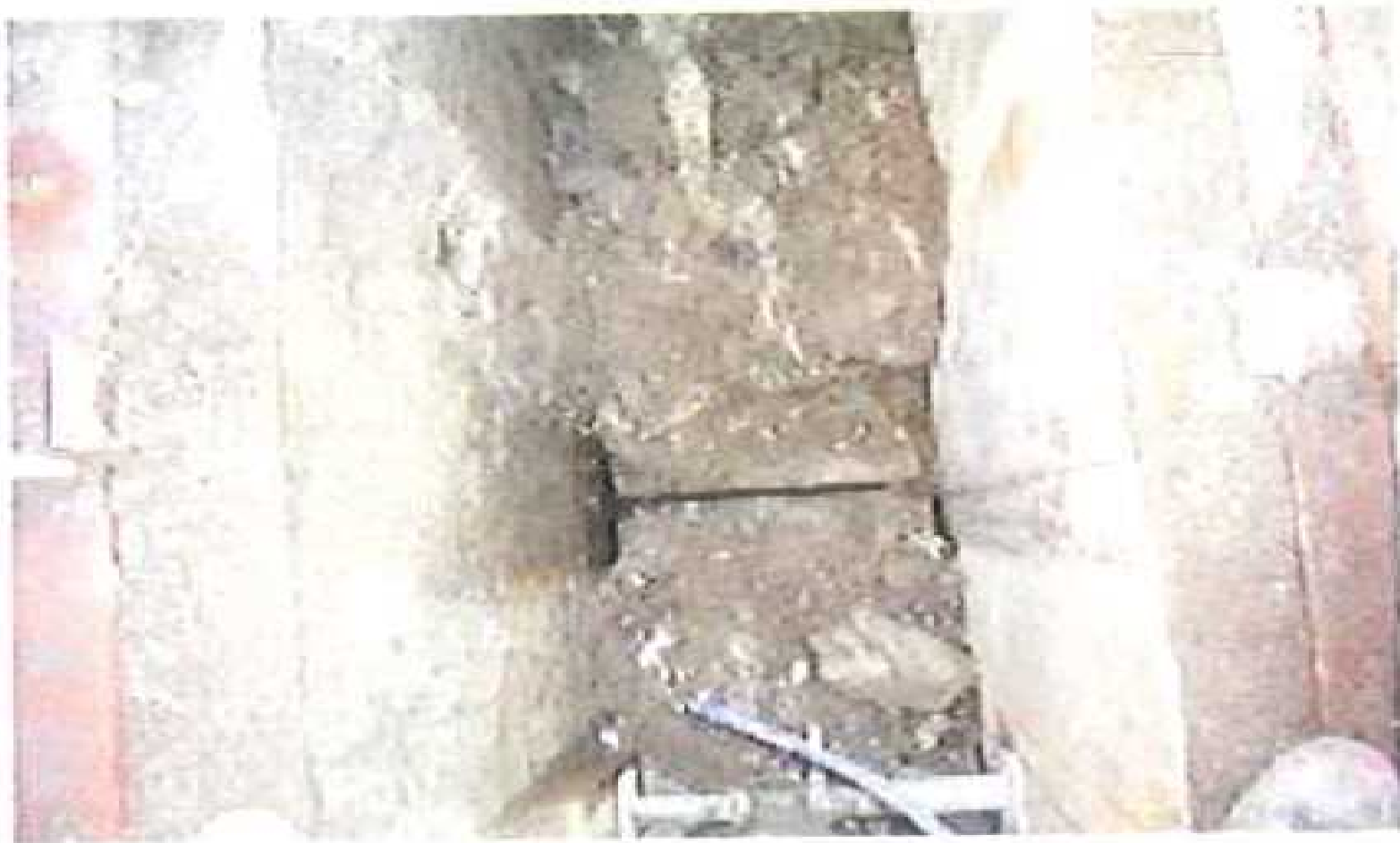
ソイルセメント改良体の H形鋼の引抜き跡
