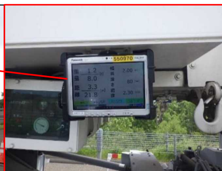
切削状況管理モニター
