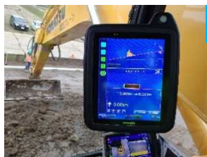
内部モニター
