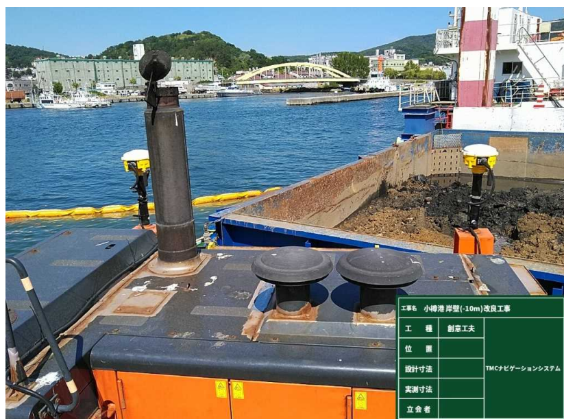
GNSSアンテナ設置状況 (取組番号 5、要領第5条2の九)
