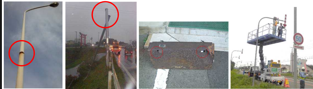
・溶接継ぎ手部の劣化 ・溶接継ぎ手部の破断 ・落下したトンネル照明 ・高所作業車による点検
