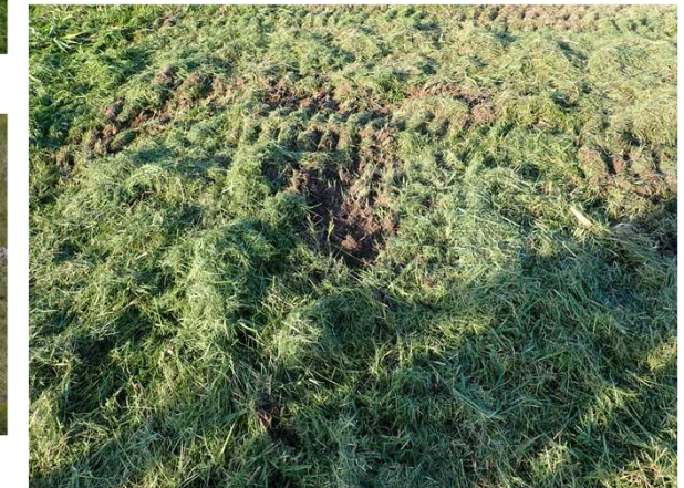
堤防の損傷状態
